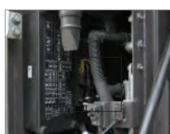
集中型配電盤ボックス (配線位置の表示カバー)
