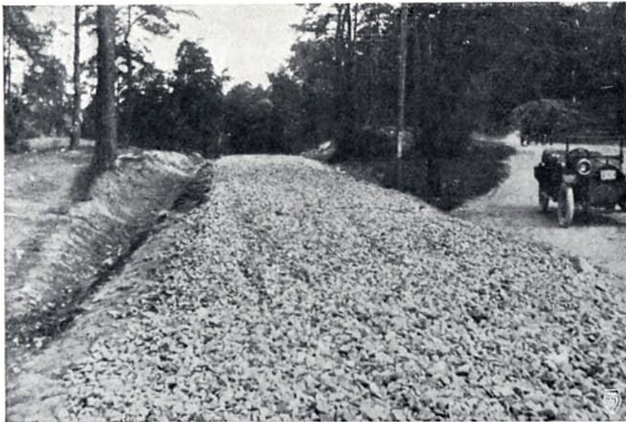
Ett halvgjort arbete. Den i övrigt vackra vägen lider brist på vältning, och trafikanterna söka sig andra utvägar.
