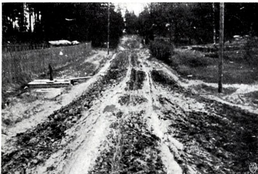
Hur en landsväg icke bör se ut. Dålig grund och dåligt underhåll.
