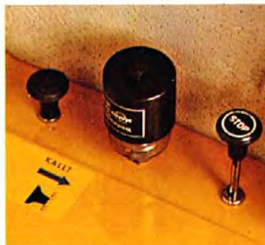
La spia del filtro è montata nella cabina ben visibile all'operatore.
