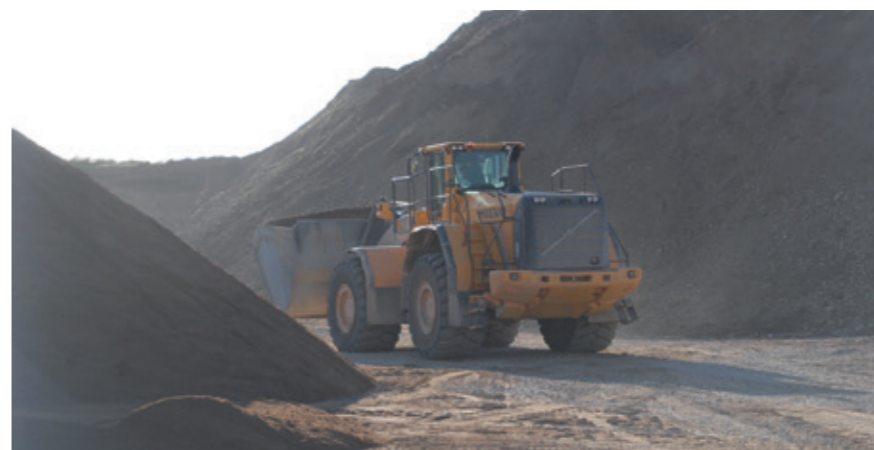
▲ Maskinfører Tage Andersen kører en del rundt i Ørup grusgrav for at holde knuse- og sorterer anlæg i gang, samtidig med at han læsser biler med stabilgrus.
