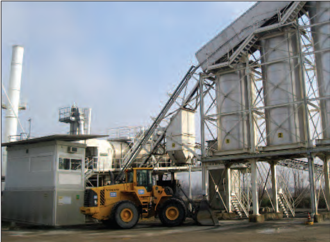
Figura 3 - L'impianto di Gossolengo (PC) per la produzione di 250 t/h
