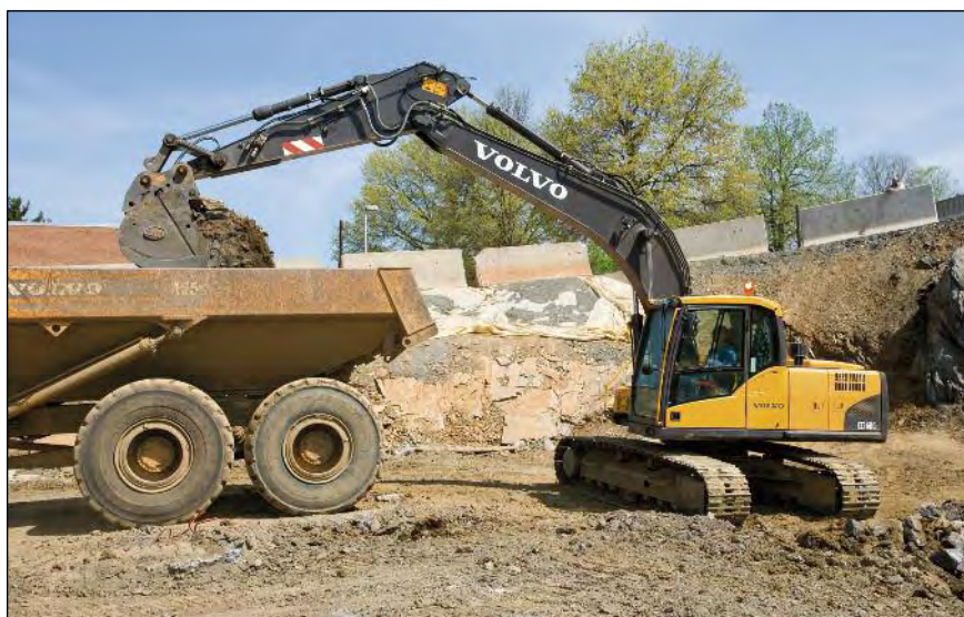
■ Un'immagine operativa dell'EC160C: in evidenza, il telaio del sottocarro, realizzato in acciaio a elevata resistenza, con angoli a doppia saldatura
