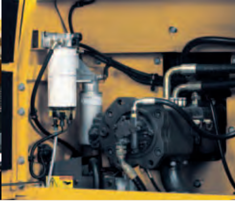
• Fácil acceso a los filtros y bombas hidráulicas.
