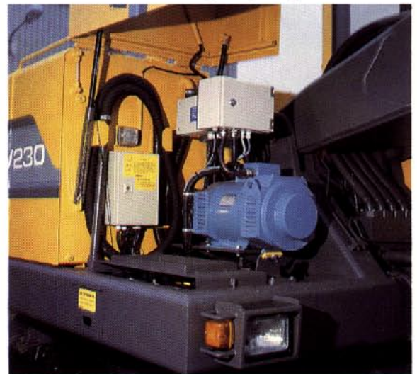
Generatorinstallation för drivning av lyftmagnet.
